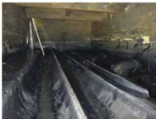
Figuur 1. Slingergoot in rioolgemaal Holwinde (Rotterdam).
