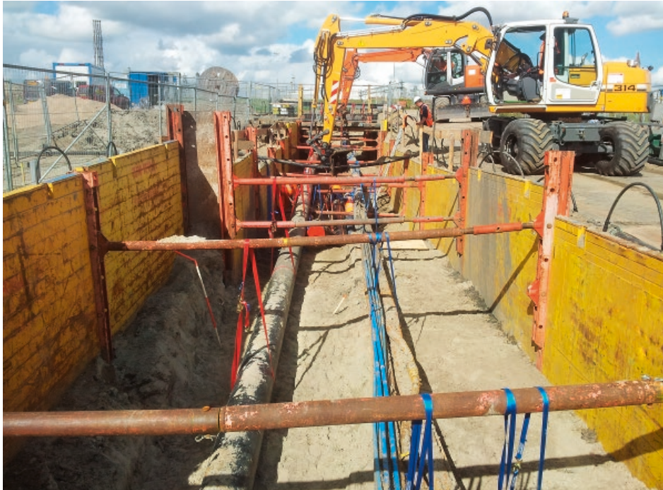
Figuur 3.1 Over een grote afstand vrijgelegde kabels en leidingen moeten ondersteund worden (Foto: Jan de Ruiter)
