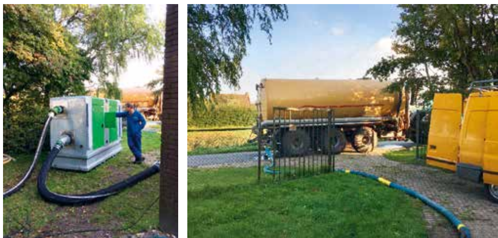
Figuur 4.5 Pompunit en watervoorraad beproeving 20 september
