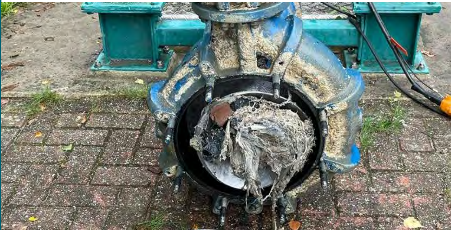
Eén van de vele door plastic doekjes vastgelopen rioolpompen
