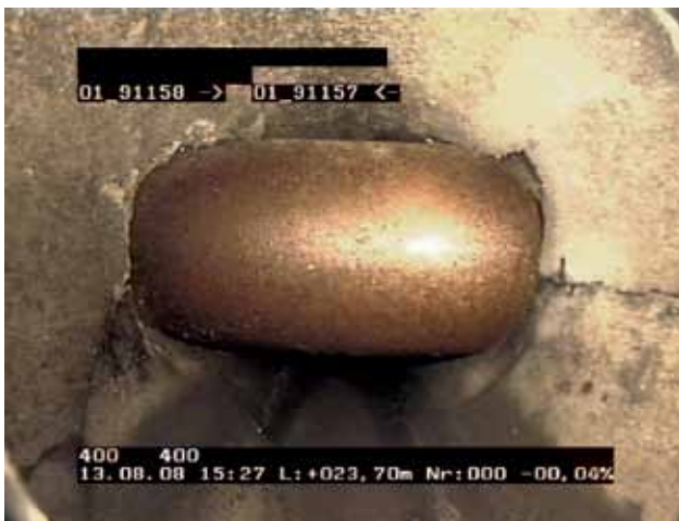
Figuur 4.2 Soms is nauwelijks afvoercapaciteit over
