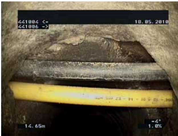
Figuur 3.1 Twee kabels slaan een groot gat in de rioolbuis
