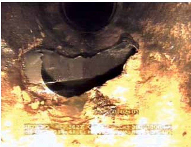
Figuur 4.1 Kunststof leiding, beschadigd tijdens rioolreiniging voor rioolinspectie
